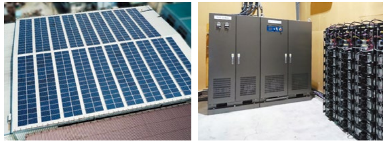
YAMABISHI海老名工場の再エネ設備。太陽光発電設備(左)と蓄電設備(右)
