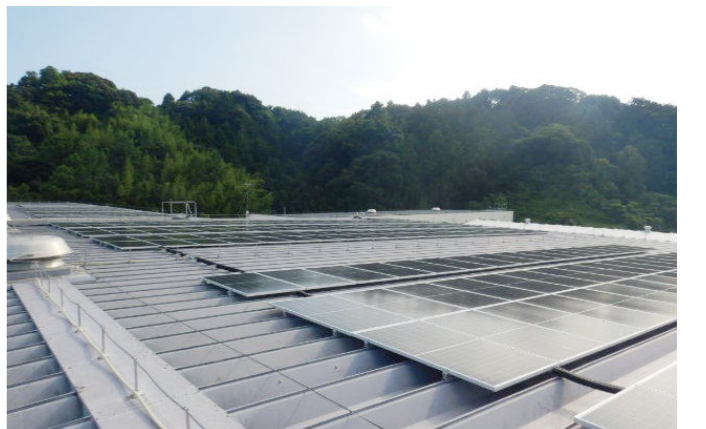
第一化成が坂口工場の屋根上に設置した太陽光パネル
