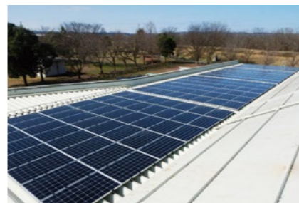
屋根上で稼働する太陽光発電設備
