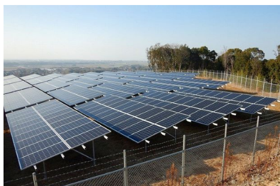
実際に再生したメガソーラー(大分県豊後高田市)
